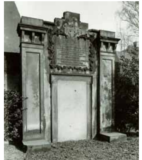
Zustand der Hügelgrabanlage Blücher kurz bevor sie 1959/60 mit einem Zuschuss des Denkmalschutzamtes erstmals restauriert werden konnte.
