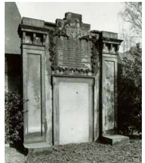
Zustand der Hügelgrabanlage Blücher kurz bevor sie 1959/60 mit einem Zuschuss des Denkmalschutzamtes erstmals restauriert werden konnte.
